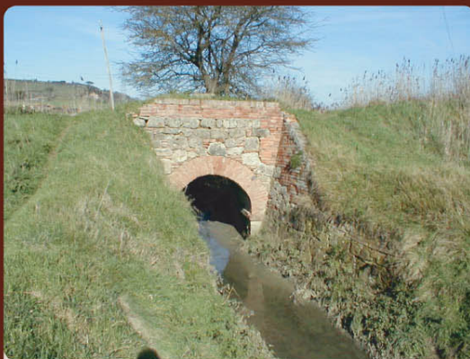
L'antico manufatto di regolazione per lo scarico verso il Tevere delle acque basse The antique handbuilt regulator sends flow towards the Tevere and low waters
