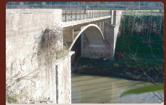
Il ponte alla Nave ricostruito a metà del XX secolo con impalcato in cemento armato sulle pile del 1890-1910
